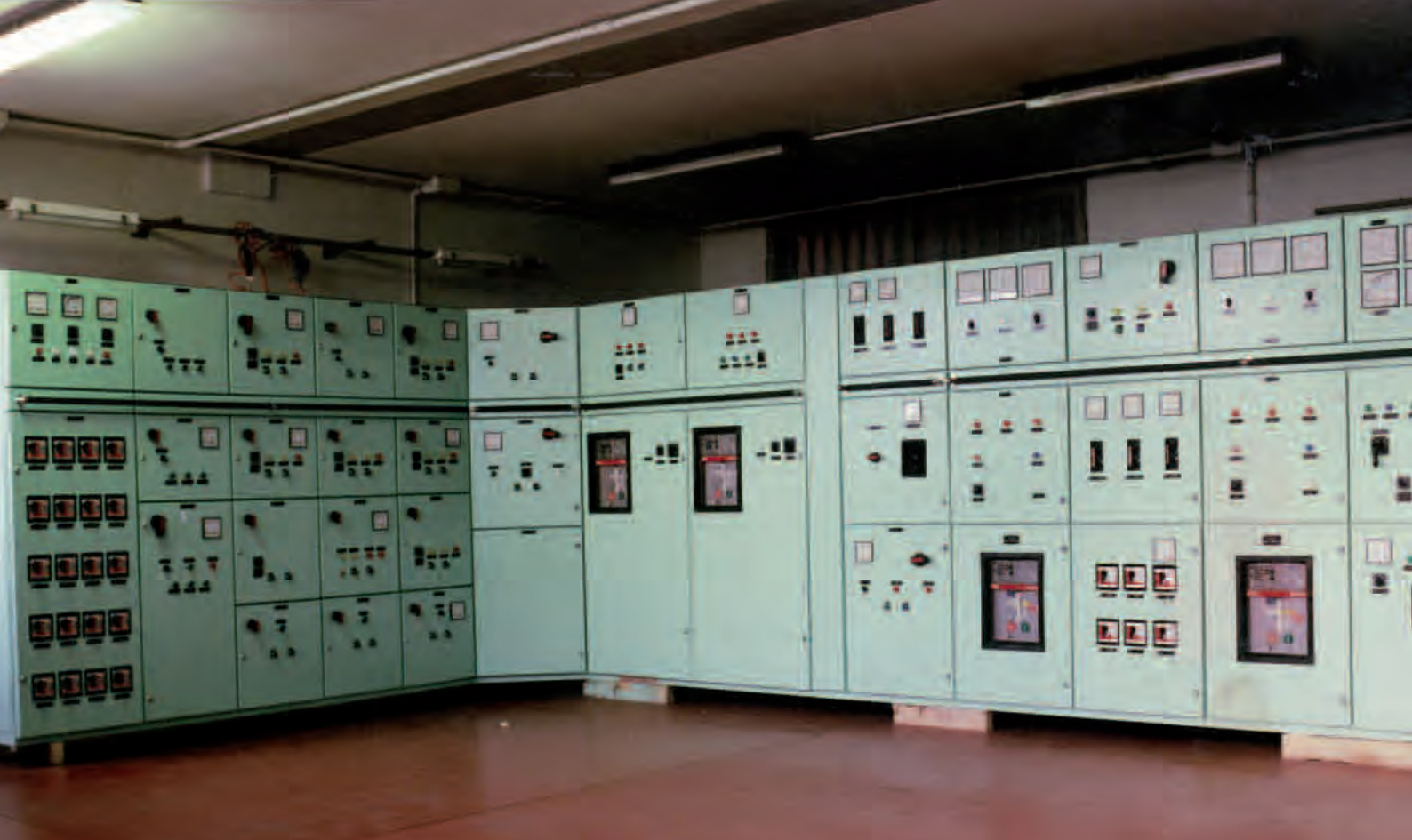
Quadro elettrico principale e MCC. Impianto costruito per una petrolchimica per conto dei Cantieri Navali Luigi Orlando di Livorno
